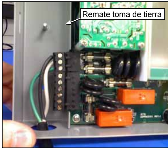
Figura 4: Conexión del cableado de potencia
